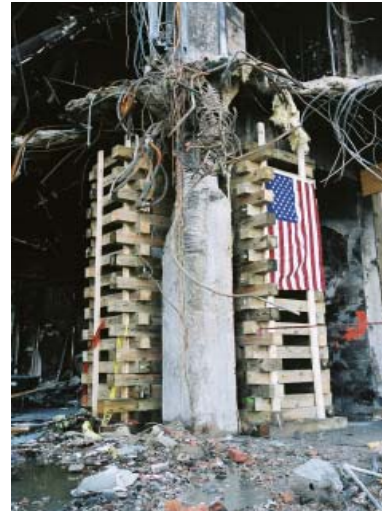
Die Kreuzstapelmethode eignet sich zur Ableitung schwerster Kräfte [Pentagon, FEMA]. Abb. A / 18
